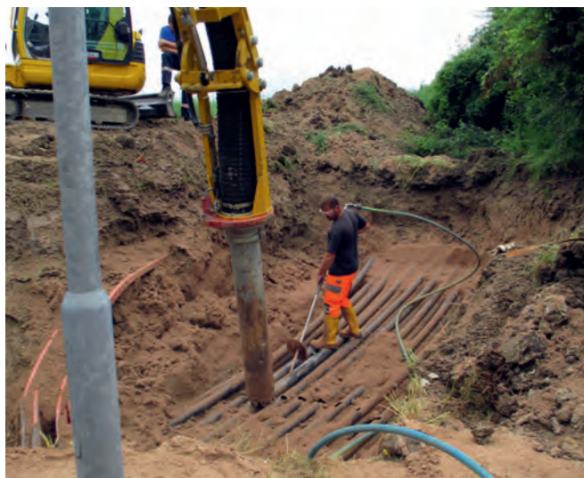
▲ Kabel- und Leerrohre
